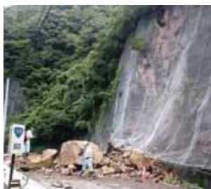
落石直後の状況
